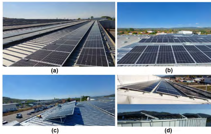
Slika 15. Dispozicija solarnih panela na krovu fabrike; a), b) Al podkonstrukcija K2 Systems Triangle na halama 2 i 3, c), d) Al podkonstrukcija K2 Systems Mini na delu krova i nadstrešnici
